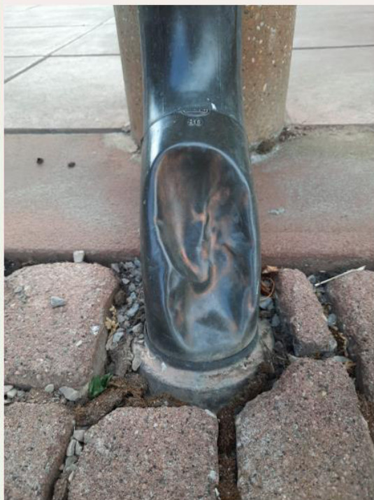
Deutlich eingedrücktes Regen-Abflussrohr
