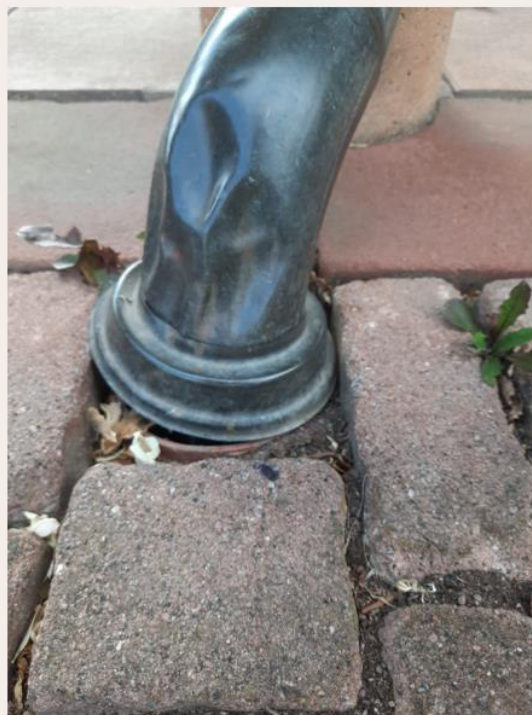
Beschädigung am Rohranschluss im Bereich des Übergangs
